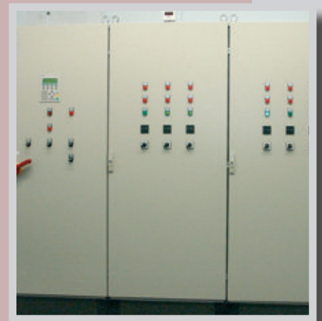
Steuerschrank für FU-Regelung Zentralversorgung / control panel for central system
