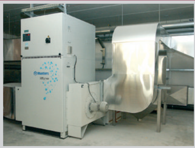
Vakuumtrockenluftförderung für PA-Granulat mit Wärmerückgewinnung / vacuum conveying by means of dry air for polyamid with heat recovery
