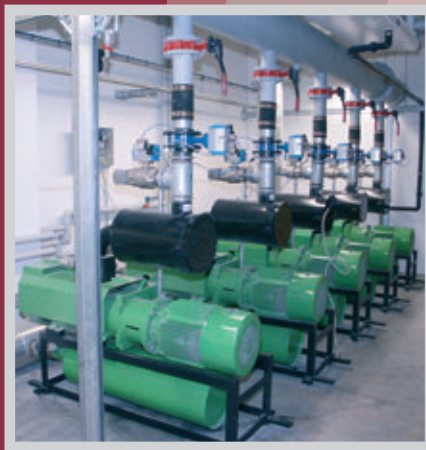
Vakuumzentralversorgung 5500 m 3 /h. Granulatförderung mit Wärmerückgewinnung aus der Abluft / centralized system 5500 m 3 /h. polyamid conveying with heat recovery.
